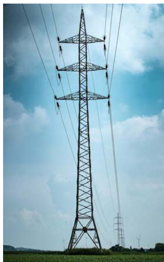
En aérien ou sous terre ? La ligne Gouy-Oisquerq se cherche toujours un futur... © BRUNO DALIMONTE
